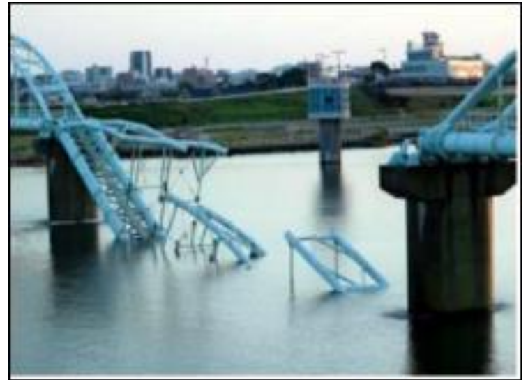
和歌山市六十谷水管橋崩落事故写真 (R4厚生労働省全国水道担当者会議資料)
